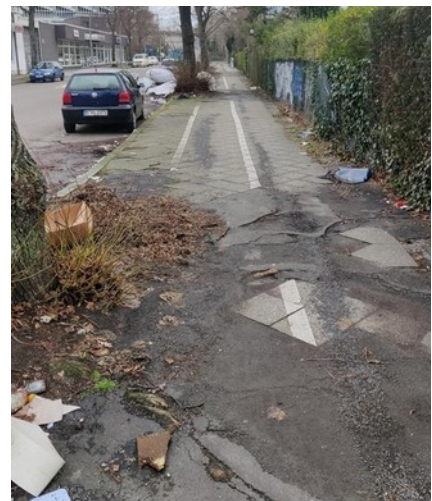
Abbildung : Beispielfoto eines Radweges mit schlechter Oberflächenqualität.
